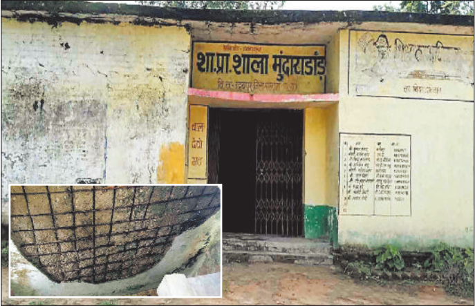
जर्जर शाला भवन, इनसेट में छत के उखड़े प्लास्टर।
